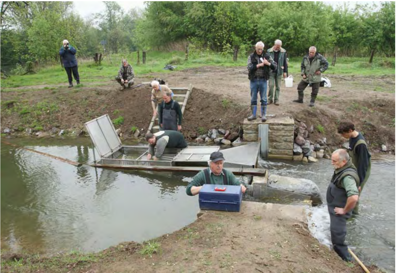
Wo das Umgehungsgerinne oben aus der Lippe abzweigt, wurde eine große Fischreuse eingebaut. Die aufsteigenden Fische kommen von unten (im Bild rechts) und schwimmen in den Trichter der Falle. Einmal am Tag zählen und messen Mitglieder des Heessener Fischereivereins die Fische und lassen sie danach flussaufwärts der Reuse frei.
